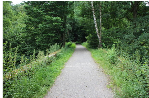
Bild 2: Viadukt Holzape mit weitgehend eingewachsenen, viel zu niedrigen Brüstungen.
