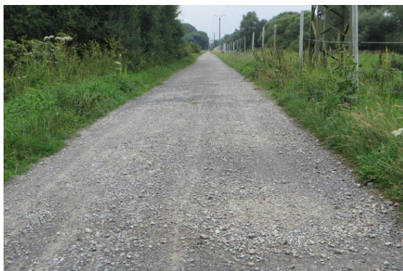
Bild 3: Blick Süd: Schotterstrecke im Detail. Zum Teil größerer Schotter und ausgefahrene Stellen vorhanden.
